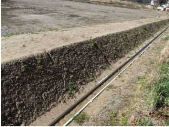
写真③ 福光地区 雑草繁茂状況
