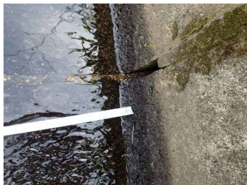
目地の欠損（水路壁）
