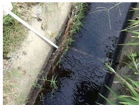
目地の欠損（水路底）
