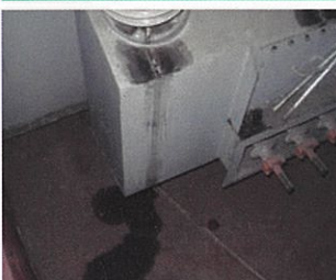
にじみ漏れの例（悪い例）
