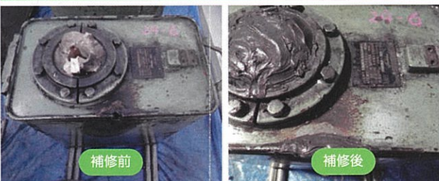
目止め材による補修例
