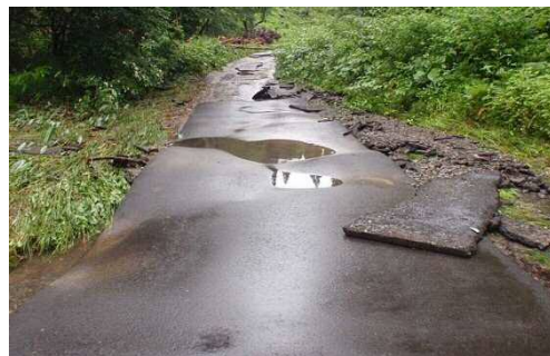
写真：舗装の被災
