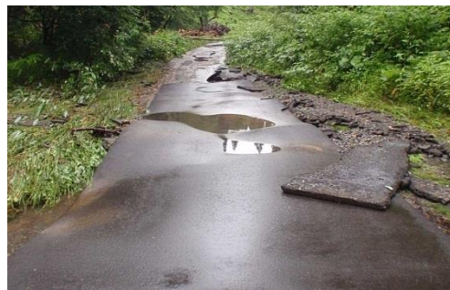
写真：舗装の被災
