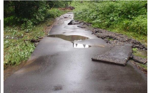
写真：舗装の被災
