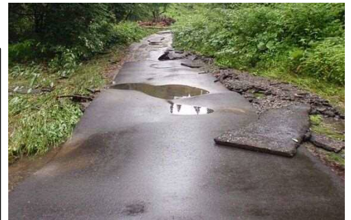
写真：舗装の被災
