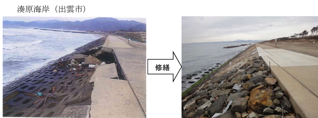
写真- 2.1 海岸保全施設の維持・修繕の実施例
