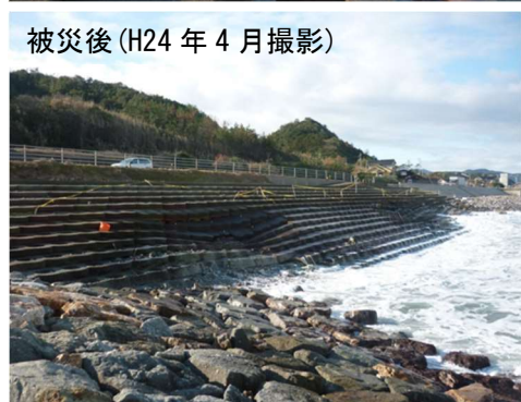
写真- 1.3 近年の施設被害の事例
