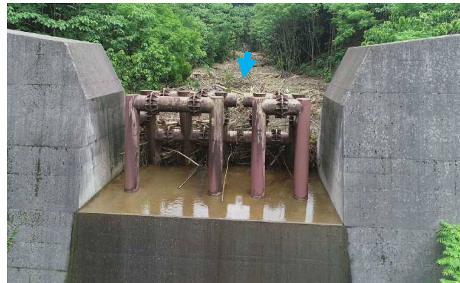
土石流発生直後 (R3.7.15 撮影)
